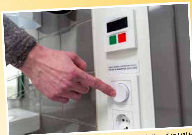
Inställning av färgtemperatur och ljusstyrka görs enkelt med en DALI-dimmer innanför dörren.
